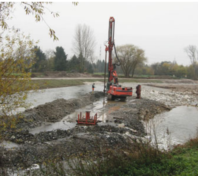
Bild 9: Zehn Meter lange Spundbohlen geben dem Wehr Halt. In die Nidda musste ein Damm als Aufstandsfläche für das Rammgerät geschüttet werden. Das Rammgerät der Spundbohlen wird hier mit einer Bohrung vorbereitet. (Foto: H. Kramer)
